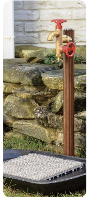
「二口横水栓ウォーターワークス(錆肌レッド)」と「水栓ハンFUNE(ブラック)」の施工例
